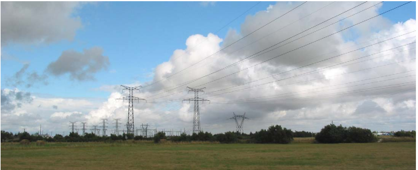
UP33-19- Les lignes à haute-tension en marge sud du marais de Brière – Montoir-de-Bretagne
