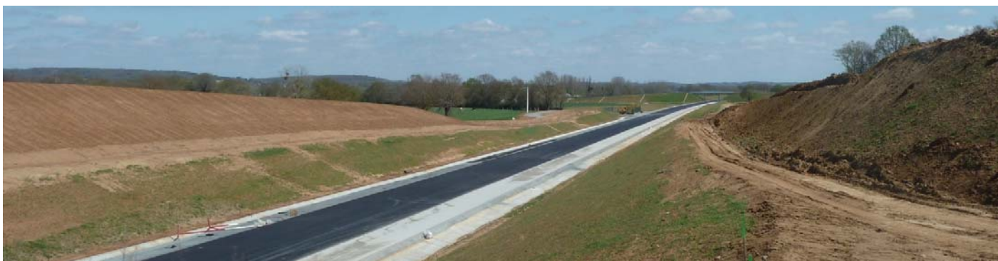
UP13-40-17 - L'aménagement de la LGV modifie fortement le paysage avec l'aménagement de remblais et crée de nombreux délaissés (Saigné-L'évêque- 2015)
