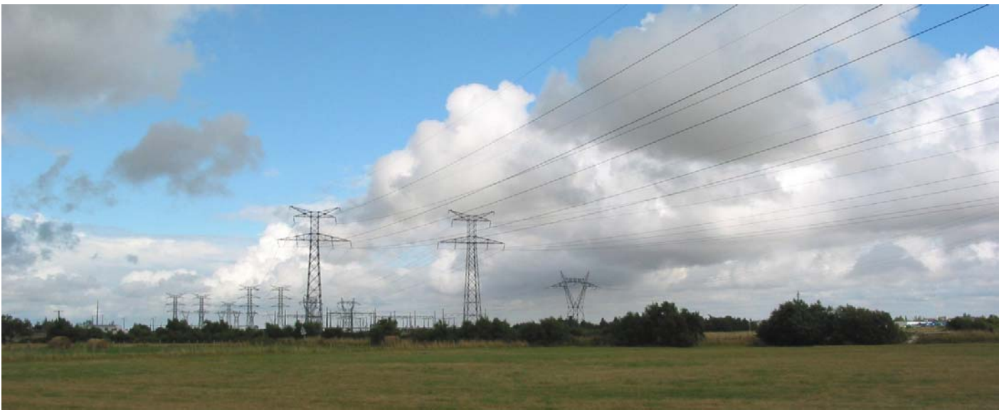
UP33-19- Les lignes à haute-tension en marge sud du marais de Brière – Montoir-de-Bretagne
